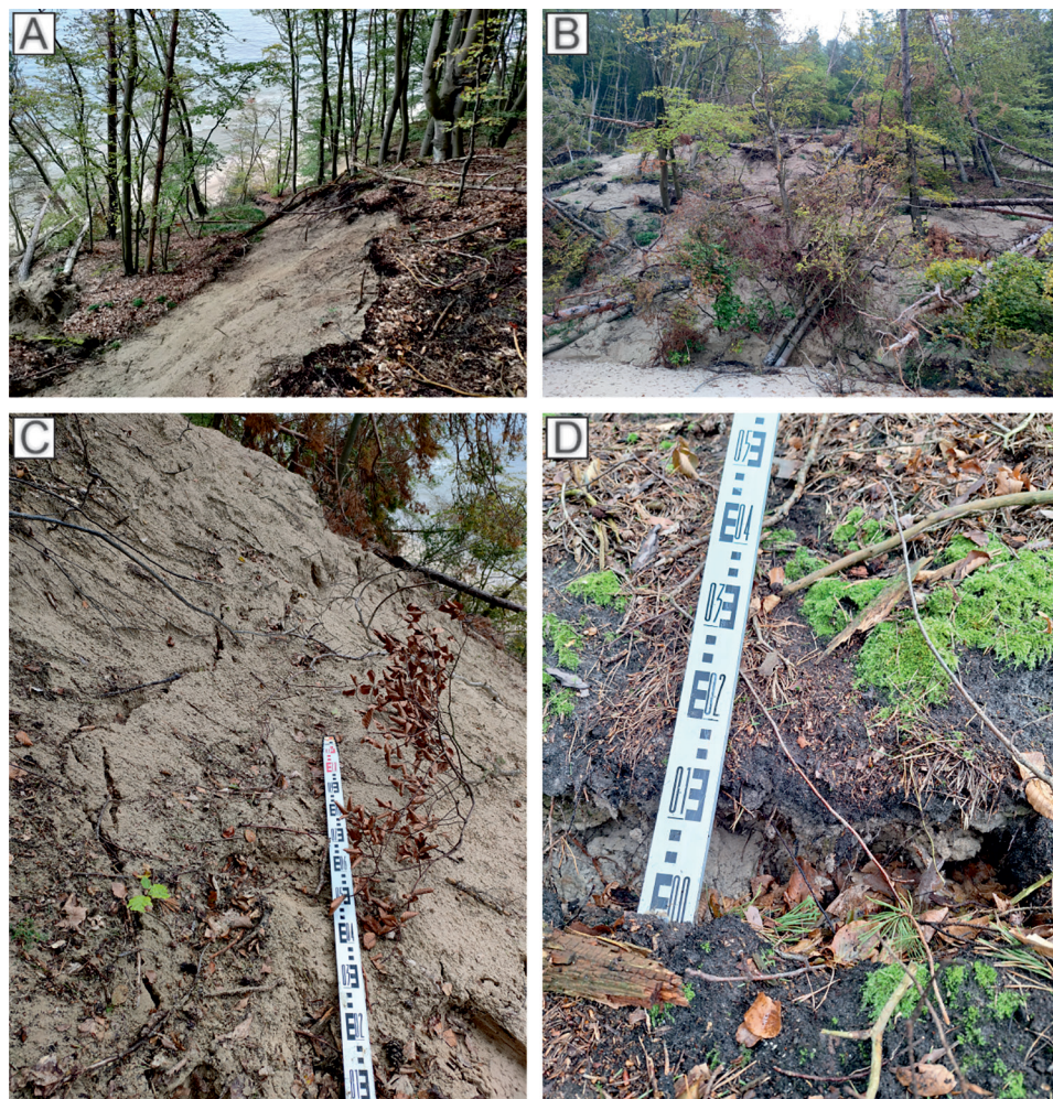
Ryc. 2. A – fragment zerwy gruntowej w obrębie klifu; B – zniszczone zadrzewienie klifu widoczne z plaży; C, D – występowanie równoległych do linii brzegowej szczelin w obrębie jezora osuwiskowego
